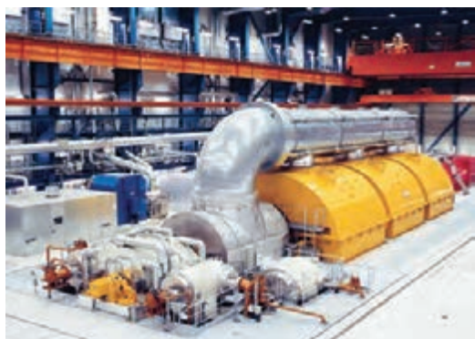
شکل ۲- ژنراتور سه فاز در نیروگاه
