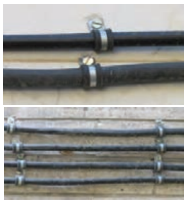
شکل ۲۵- کابل‌کشی روی دیوار
