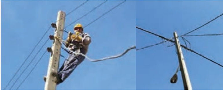
شکل ۴- کابل هوایی و خودنگهدار
