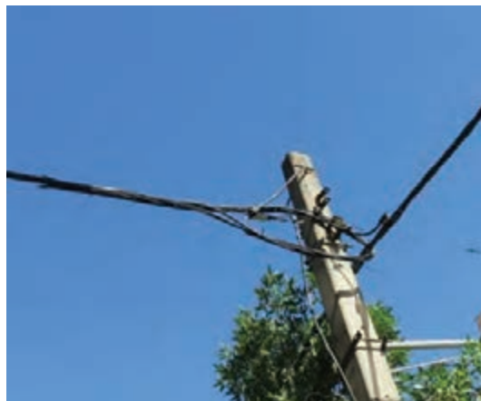
شکل ۲- کابل خود نگهدار
