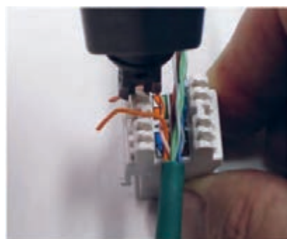
شکل ۱۹-۲- استفاده از یک نوع دستگاه پرچ
